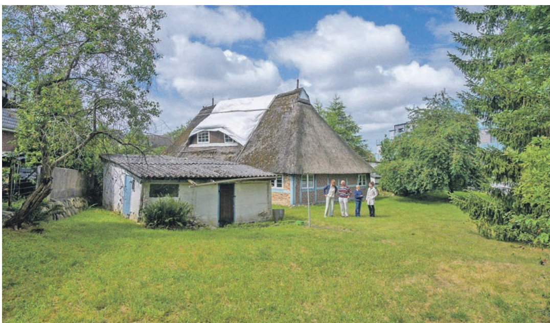
Blick über den Katen-Garten auf das marode, durch eine Plane notgesicherte Dach.
