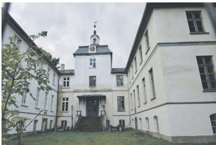
Am 23. September 2023, als vor Ort eine Katastrophenschutzübung durchgeführt wurde, zeigte das denkmalgeschützte Schloss Rantzau sehr deutliche Spuren des Verfalls. Über der Freitreppe ist die Stein- tafel für den Bauherrn Heinrich Rantzau noch zu sehen. Die Seite https://de.wikipedia.org/wiki/Schloss_Rantzau_(Rantzau) zeigt von dem Schriftzug eine Nahaufnahme. Foto: Lotta Schneider
